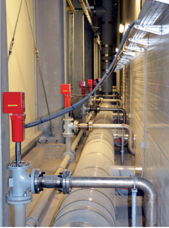
Levha rafının arkasında Vapor hattı, her sertleştirme odası için bir vana ve hava dağıtım hattı bulunan hat koridoru.
