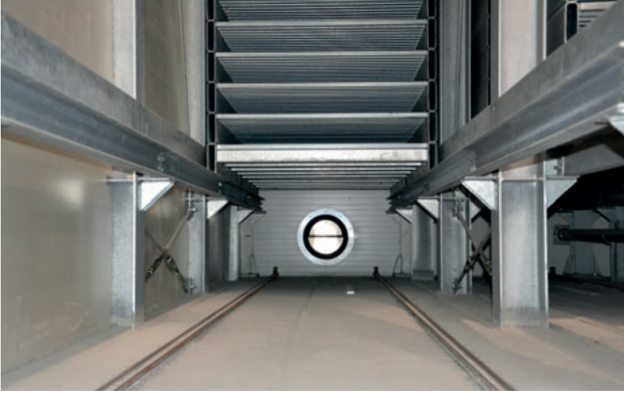
Levha rafının altında sıcak hava girişi.
